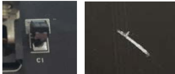
그림 3.3. 부품 탈락 및 외부 손상 상태 예시
